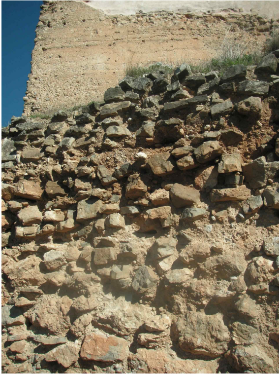
Fig. 8.- Lienzo del castillo realizado mediante mampostería trabada. (Fotografía de archivo de la UPV).
