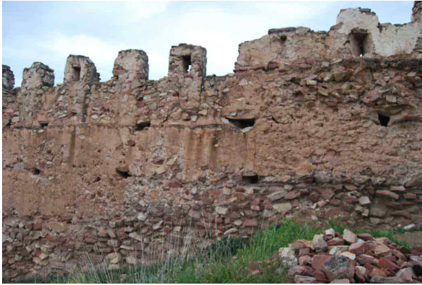
Fig. 4.- Foto del muro interior norte, donde se observan los módulos y los agujeros dejados por las agujas inferiores. (Fotografía de archivo de la UPV).
